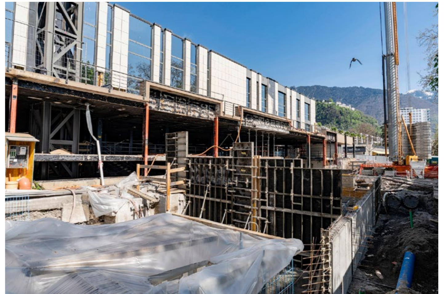
Sous les quais se trouve la station de pompage qui jusqu'à présent ne servait qu'au refroidissement. Ce système s'inscrit désormais dans un projet plus large de chauffage à distance.
