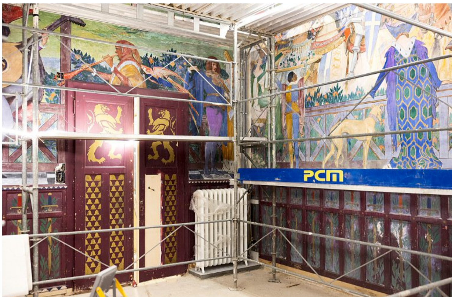
La Villa Bunau-Varilla est la première villa en béton armé de Suisse. Ci-dessus, les peintures d'inspiration médiévales de la salle à manger.
