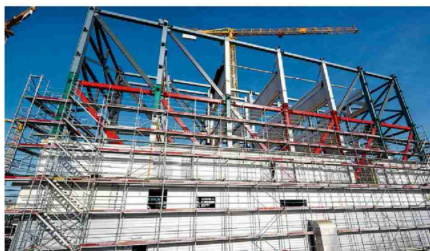
Les 14 étages de la tour ne pèseront pas sur le centre commercial, qui abrite une piscine à cet endroit. Pour les soutenir, une structure métallique a été construite avec des piliers plantés dans le sol de part et d'autre du bâtiment existant. Florian Cella
